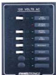
9972305B - 06 Disjuntores de CA com 01 Principal de 30A e Luzes de Indicação (ON) - 04 Disjuntores Instalados e 04 Reservas
