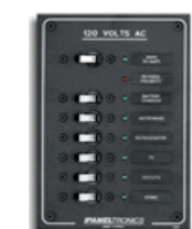
2305 - 06 Disjuntores - 01 Disjuntor Principal CA
